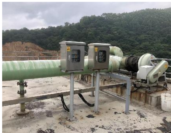
臭气密闭收集装置
