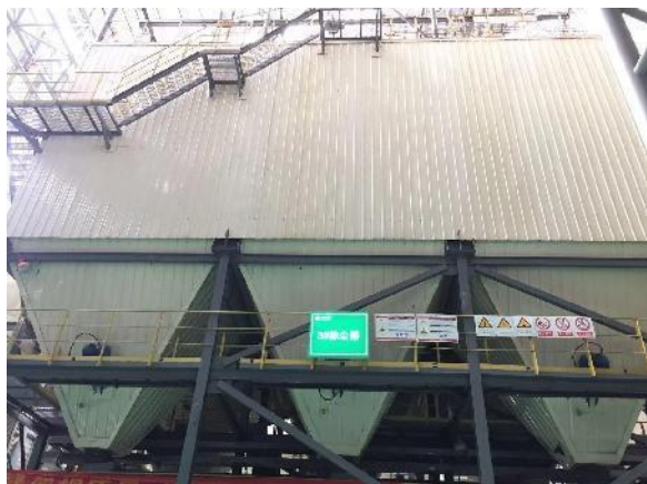
焚烧炉烟气处理-布袋除尘器
