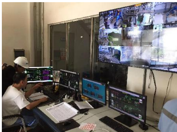
渗滤液废水中控室
