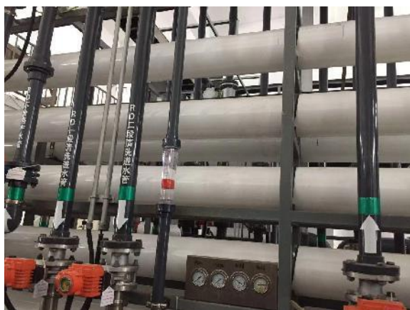
RO反渗透膜系统
