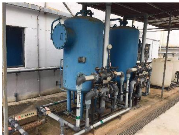
活性炭过滤器
