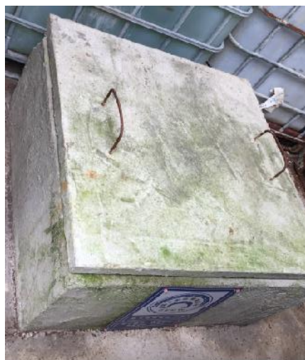
地下水监测井
