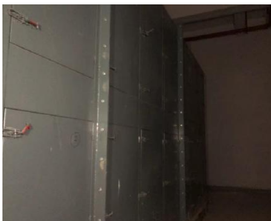
停炉废气处理-活性炭吸附箱
