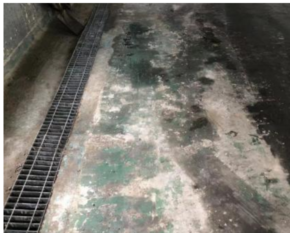
养护间收集沟
