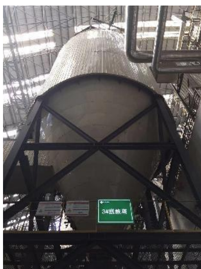
焚烧炉烟气处理-脱酸塔
