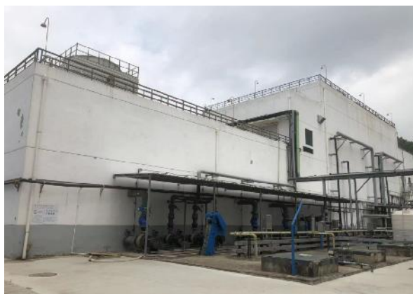
高浓度污水（垃圾渗滤液）处理系统
