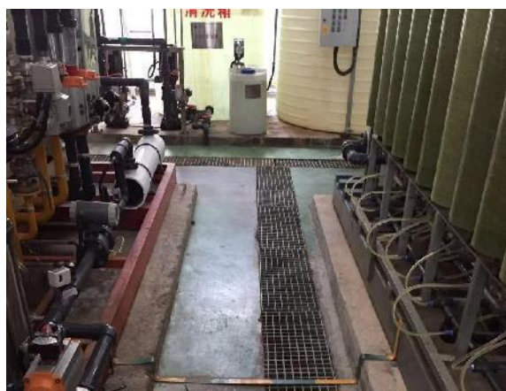
高浓度污水处理设施应急收集槽
