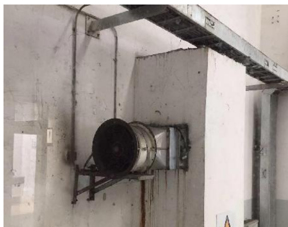
垃圾储坑吸风口
