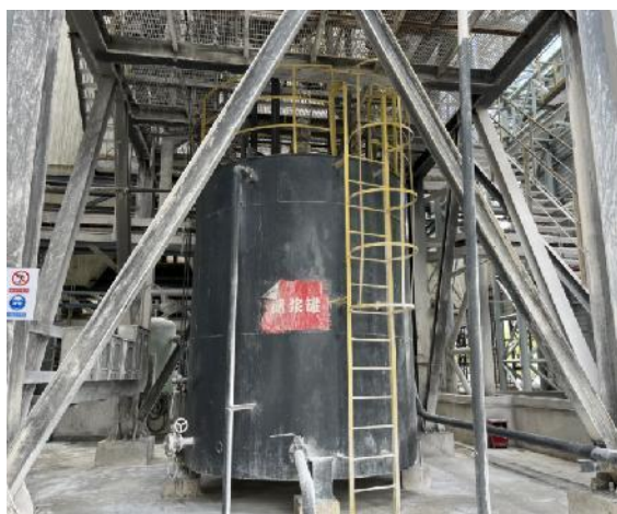
石灰浆制备间
