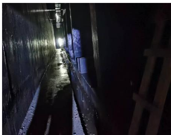
车间渗滤液收集
