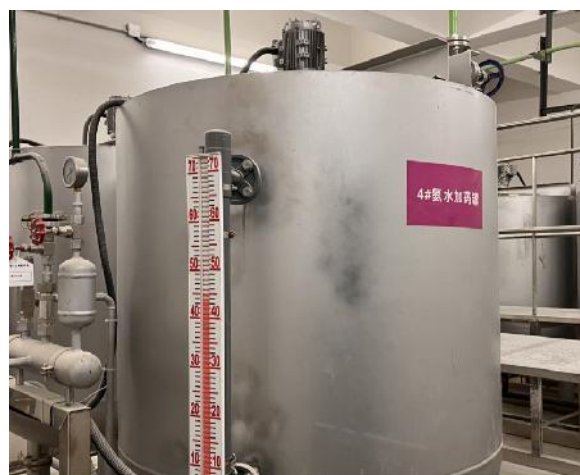
化水间氨水罐
