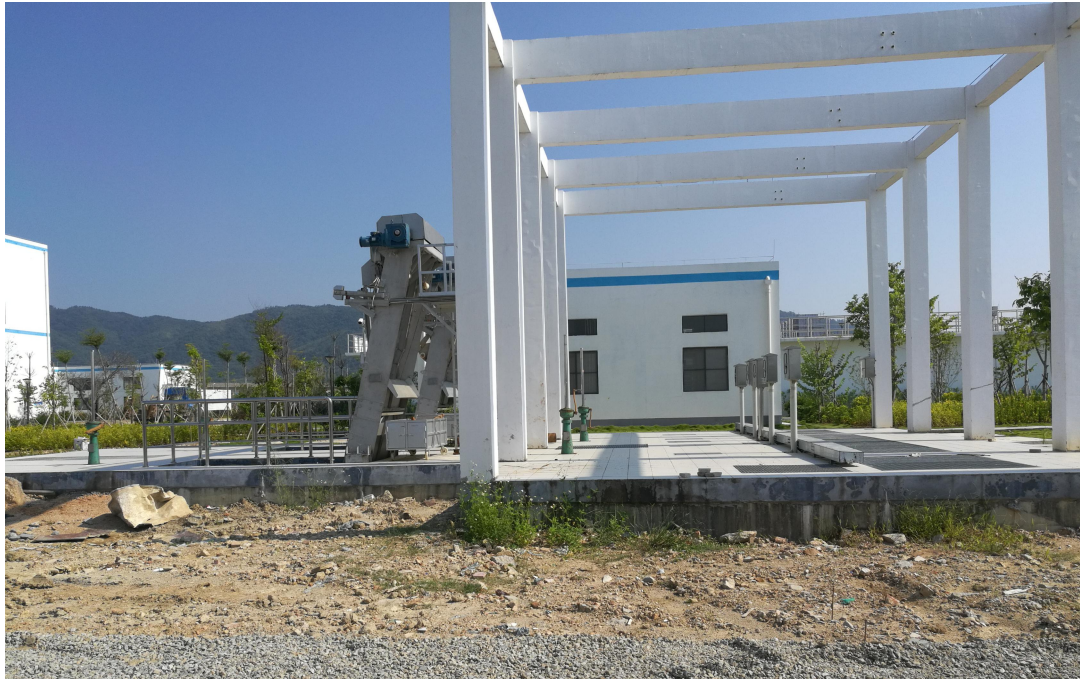
图 1-6 占陇镇污水厂提升泵房
